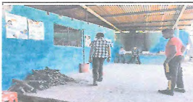
Foto 6: Piso de concreto dañado y rústico.
