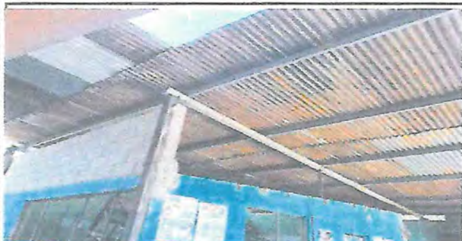
Foto 3: Falta de estructura.
