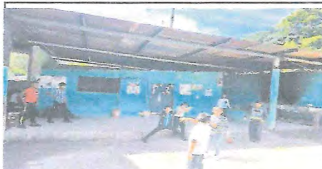
Foto 4: Estructura de metal muy distanciada una con otra.
